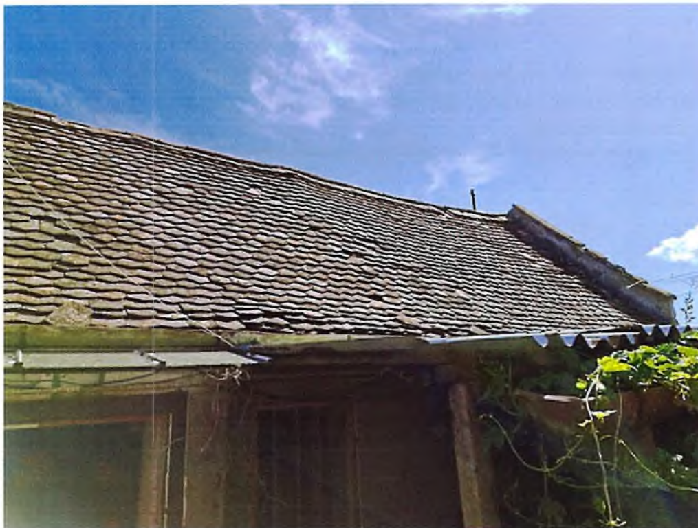
Obrázok 1: Vypadané škridly. Zatekanie spôsobilo prehnutie krovu. Padajú ce škridly (vľavo nad rýnou) ohrozujú zdravie. Nutná výmena škridly.
