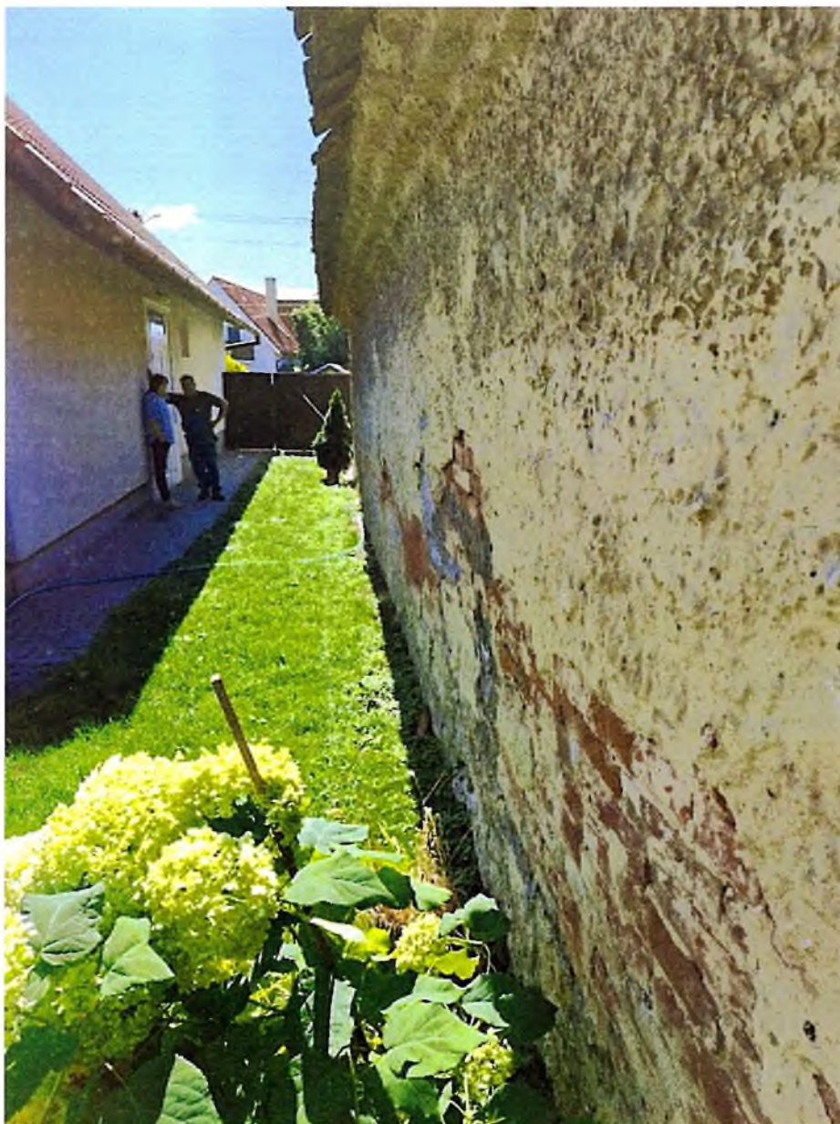
Obrázok 7: Naklonená stena cez polovodi dĺžky domu. Nutná asanácia. Hrozí náhle zrútenie od dažďa alebo vetra, ev. zemetrasenia. Do mesiaca buď asanovať alebo zabezpečiť rozperkami proti pádu.
