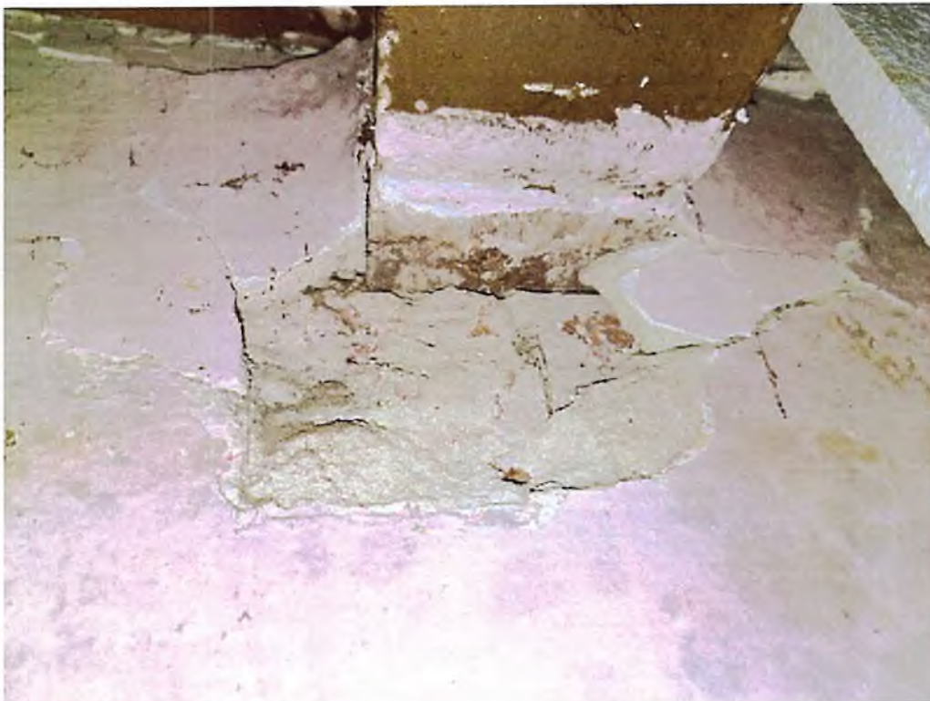
Obrázok 8: Trám stropu vytrhnutý zo steny v mieste, kde sa stena naklonila k susednému objektu na s.č. 101.
