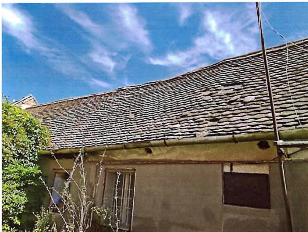
Obrázok 2: Rôzny priehyb krovu ukazuje na koniec životnosti. Chýbajúce škridly ukazujú na zatekanie. Nutná výmena krovu aj škridly, nakoľko už nedrží a padá.
