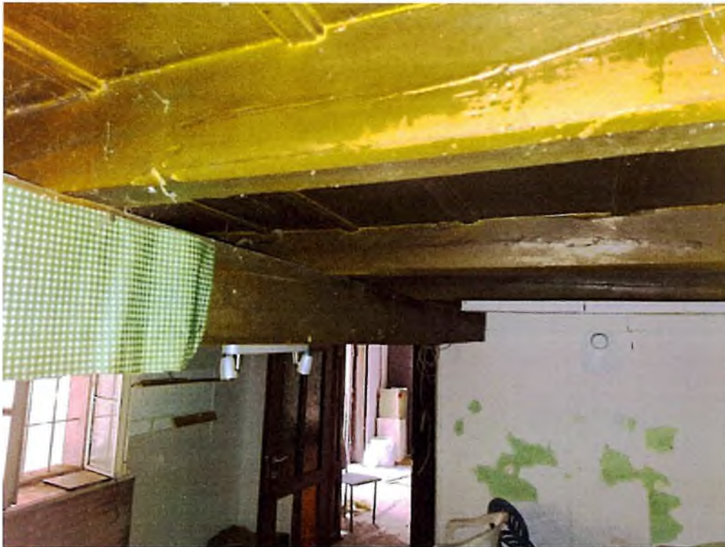
Obrázok 3: Doplnený nosný trám. Nízka podchodná výška. Nutné posúdenie architektom, ev. výmena nosníka stropu.
