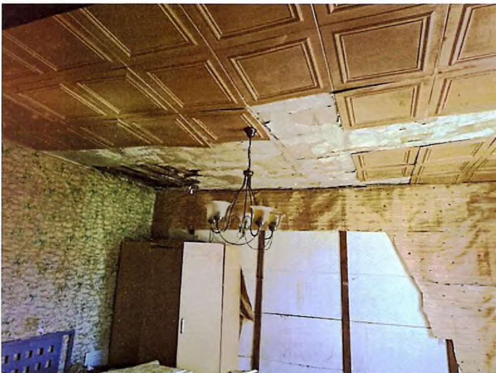
Obrázok 4: priehyb stropu. Nutná výmena.
