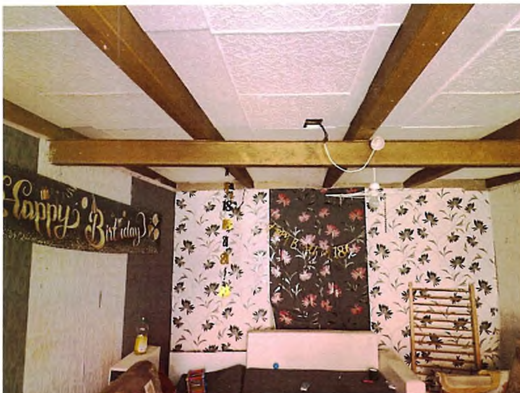
Obrázok 6: Dodatočne doplnený nosník pozdĺž domu. Strop nie je únosný. Nutné vymeniť strop.
